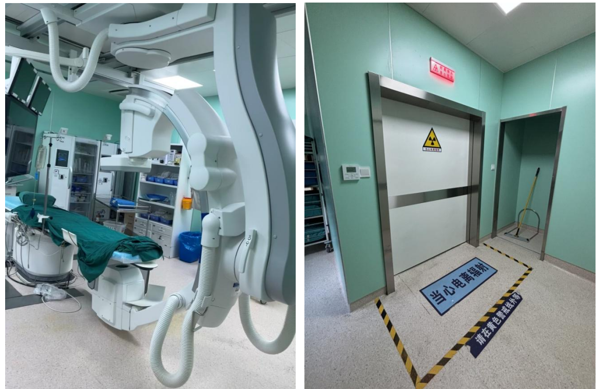
图 4-4 南白象院区住院楼 2 号三层 9 号导管室 DSA、受检者候诊门、工作状态指示灯、电离辐射警示标志及黄色警戒线
